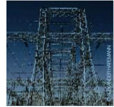
immagine Piloni di stazione elettrica.
